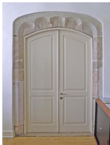
Fig.3.135 – A porta manuelina no nível semienterrado da casa. Fonte: fotografia da autora, 2014.
